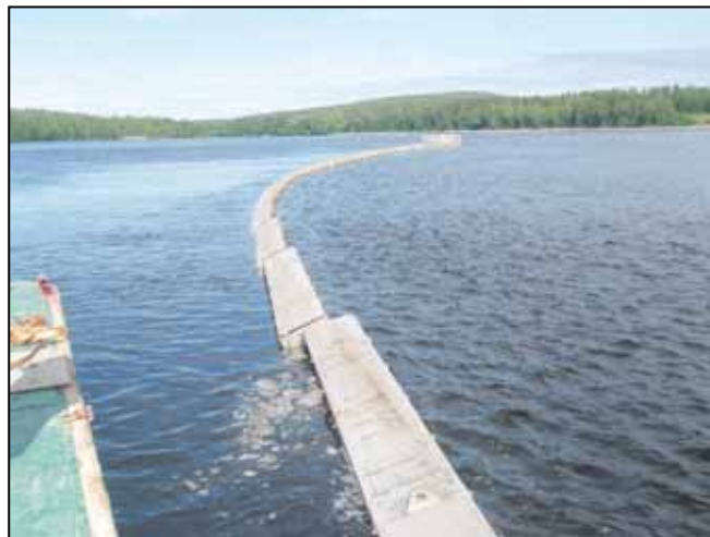
Den fiskavledare som installerades vid regleringsdammen 2010 avser både avled smolt och utlekt lax och öring. Foto: Åke Forssen
